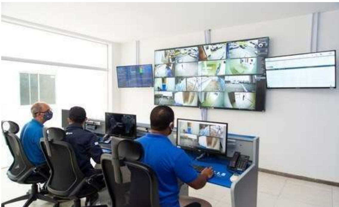
Central de monitoramento em tempo real
