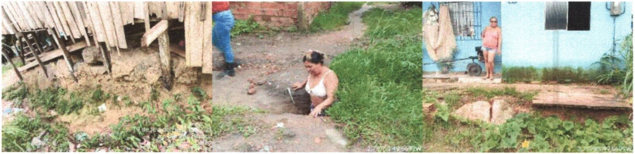
Localização: -2.787875, -49.669767. Travessa Samuel Bechimol, com residências em terreno com declive e erosões em sua base e rachaduras em suas estruturas devido às fortes chuvas.
