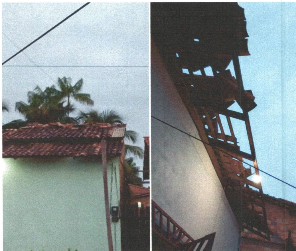
Localização: -2.797758, -49.668319. Destelhamento de residências na Tv. Jofre dos Santos.
