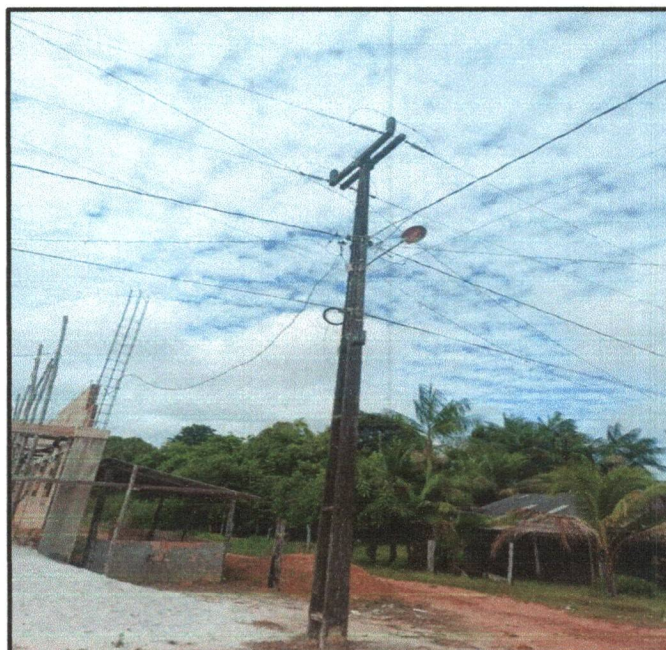
Poste de Iluminação Pública fornecida pela Equatorial Energia S.A. Fonte: Reinaldo Patric R. Sampaio
