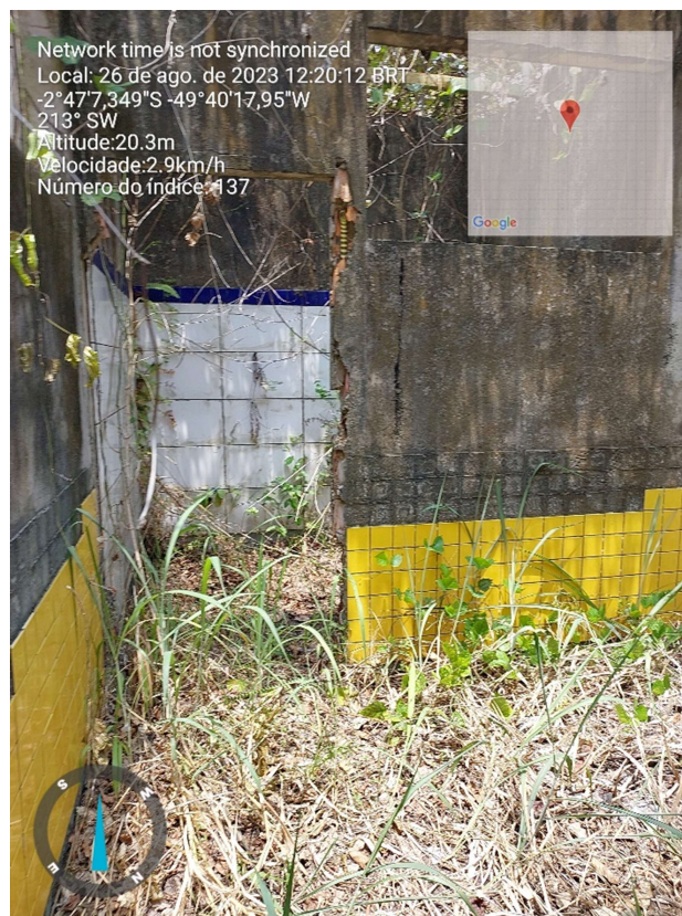
Figura 06 – Revestimento cerâmico deslocando. Fonte: Própria.
