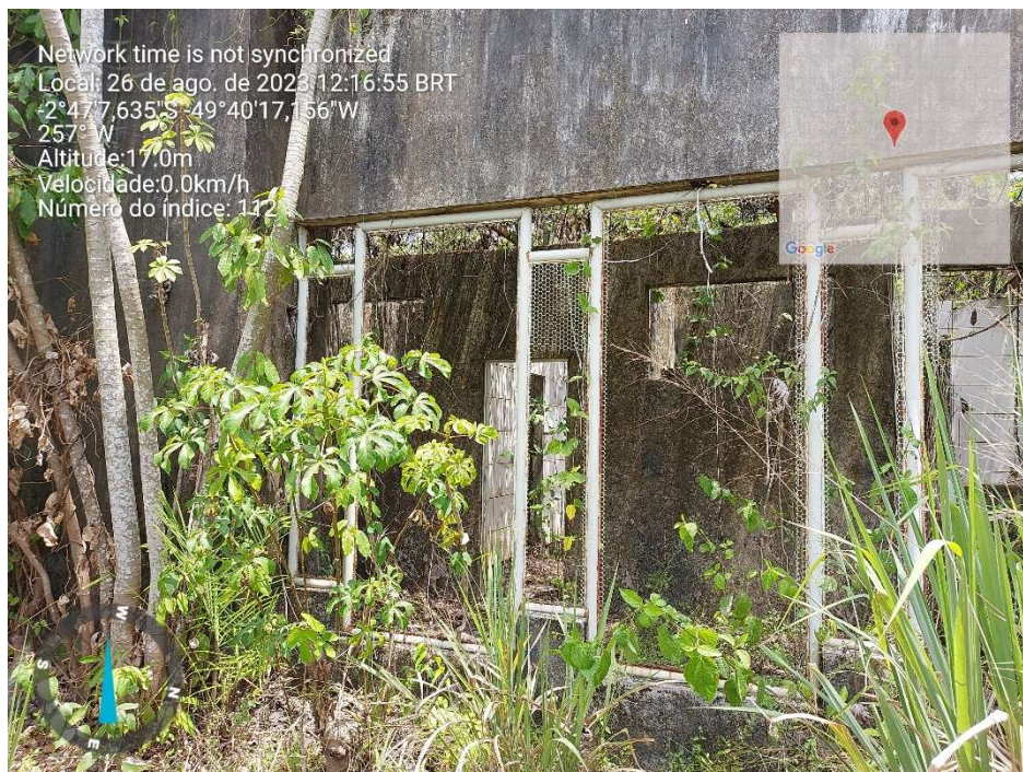
Figura 04 – Telas deterioradas. Fonte: Própria.
