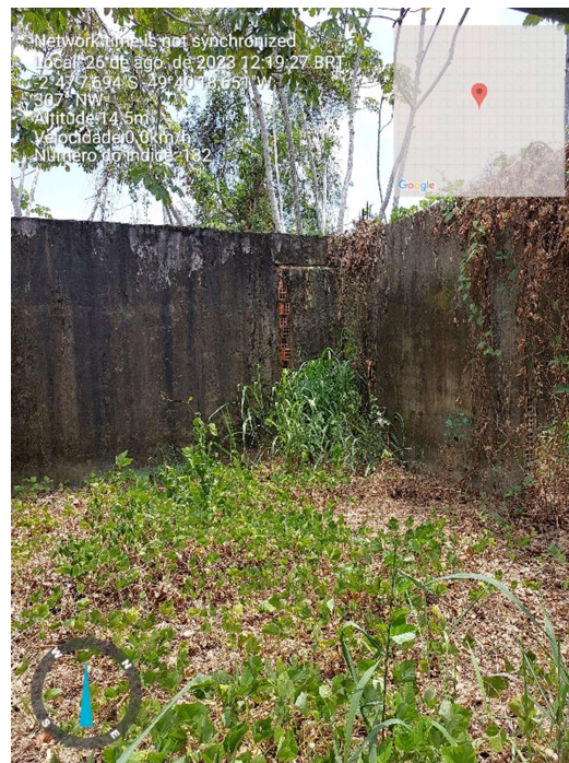
Figura 07 – Presença de lodo. Fonte: Própria.
