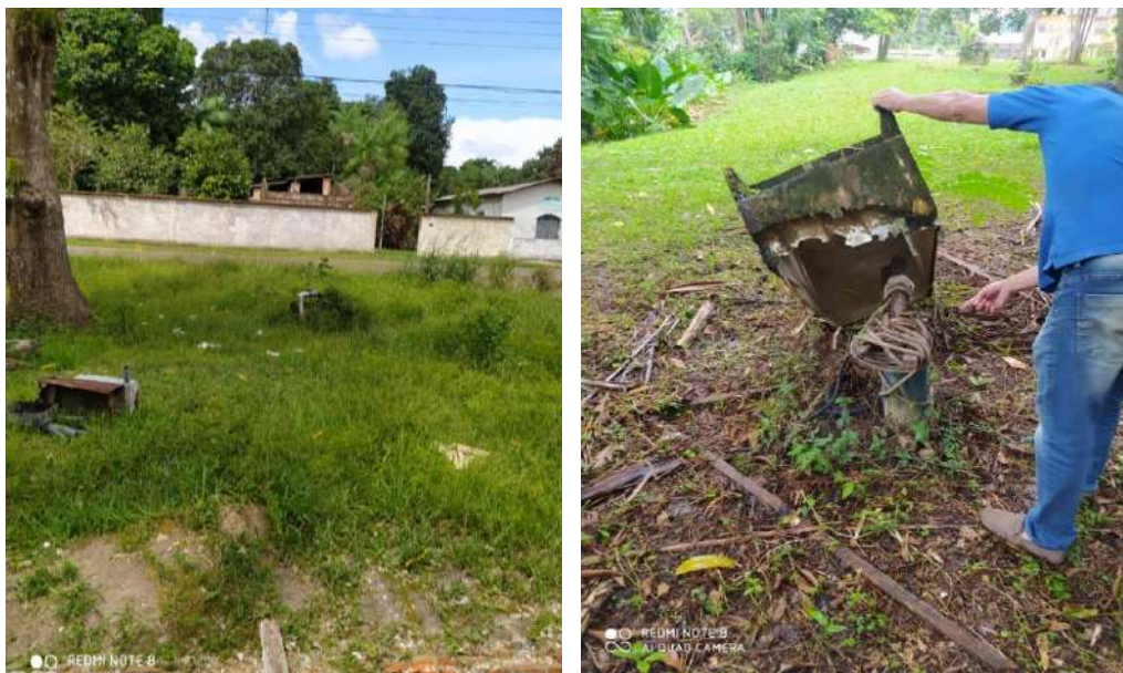
Figura 34: Situação das áreas dos poços do SAA Benfica e Murinim
