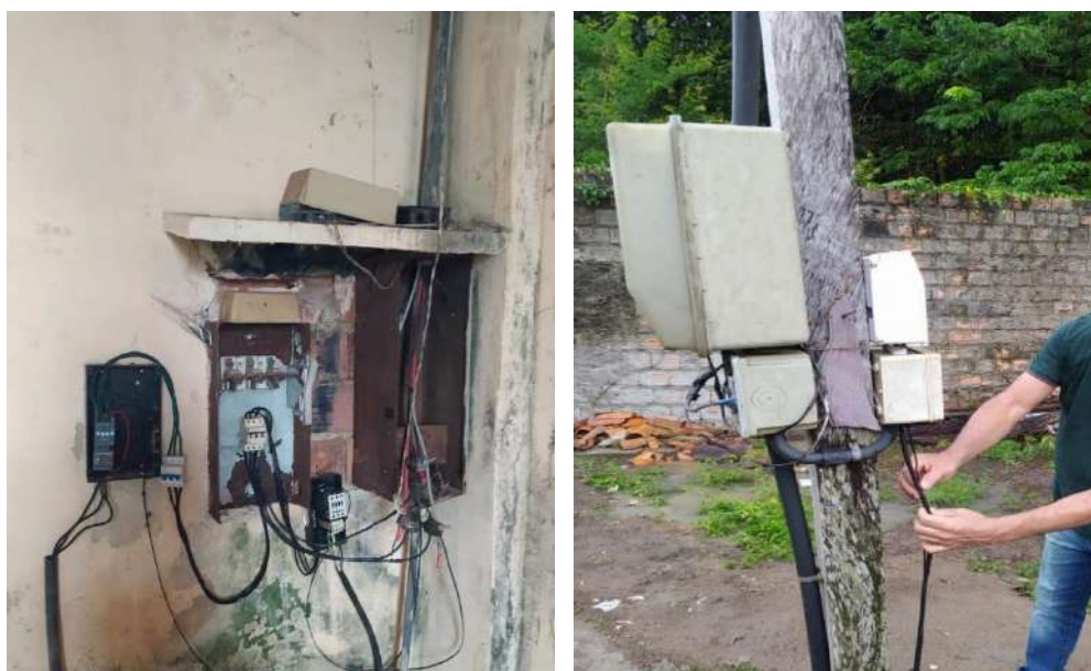
Figura 35: Quadro de comando sem abrigo e fiação elétrica exposta em área não cercada
