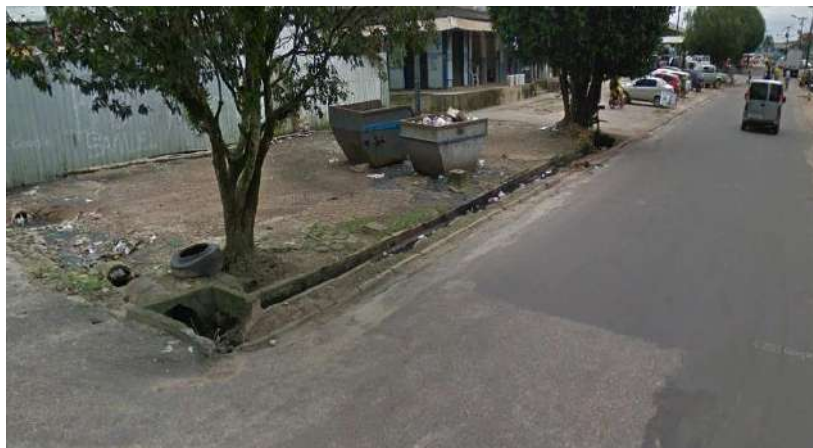
Figura 103: Boca de lobo e canaleta obstruídos presentes na esquina da Rua Apolinário Mendes com a Avenida Joaquim Pereira de Queirós, Bairro Centro
