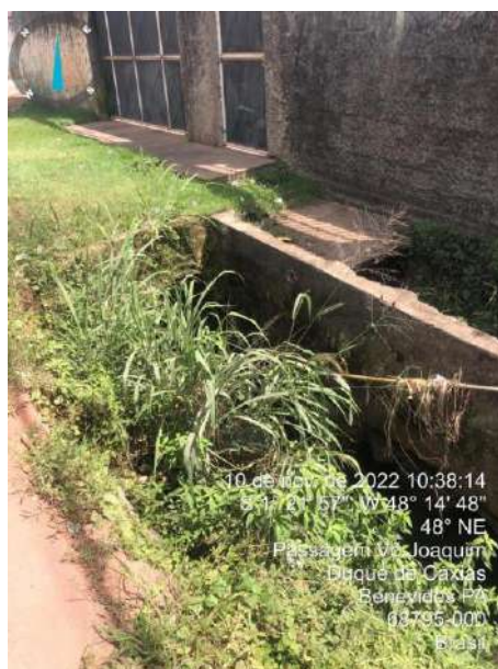
Figura 76: Presença de esgotos domésticos em canais de drenagem
