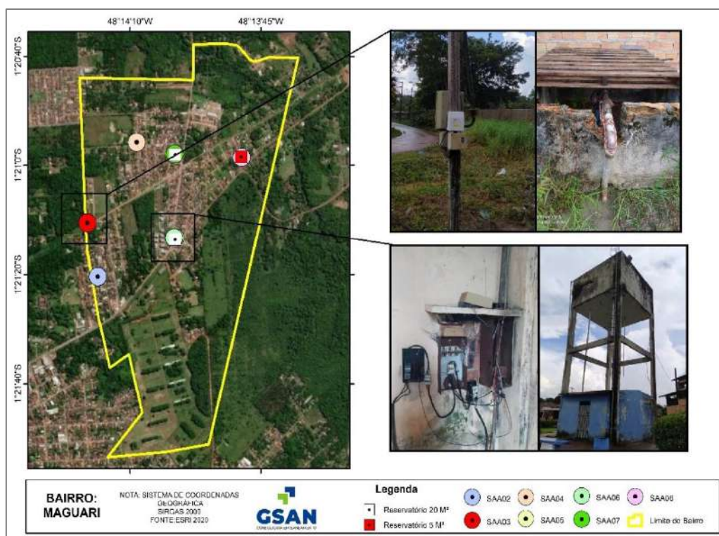
Figura 46: Microssistemas de abastecimento de água SAA02, SAA03, SAA04, SAA05, SAA06, SAA07 e SAA08, Bairro Maguari
