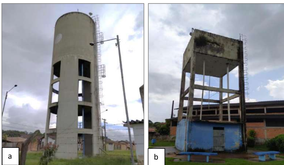
Figura 37: a) Reservatório elevado de 300 m 3 para atendimento o bairro COHAB e Bairro Juritis, da zona urbana de Benevides; b) Reservatório elevado de 20m 3 para atendimento do Bairro Maguari
