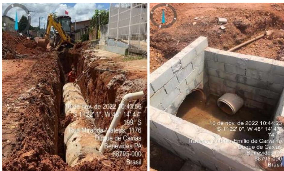
Figura 109: Rede de águas pluviais instaladas na Rua Miranda Mateus, Duque de Caxias
