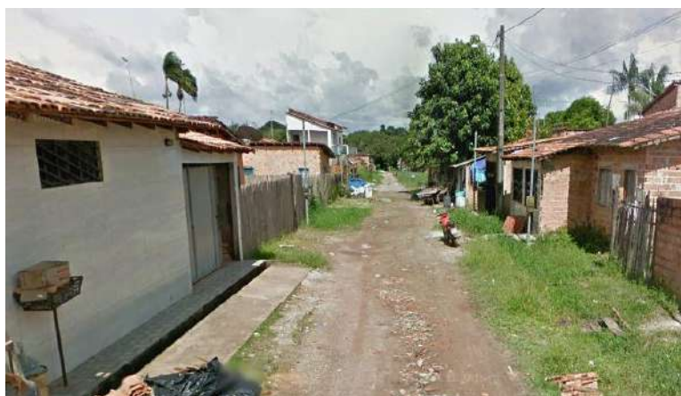
Figura 95: Ausência de pavimento na Rua São Benedito, Bairro Independente
