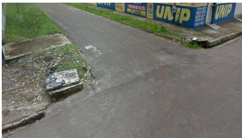
Figura 100: Meio-fio deteriorado e bocas de lobo presentes na esquina da Avenida Castelo Branco com a Rua Nações Unidas, Bairro Liberdade
