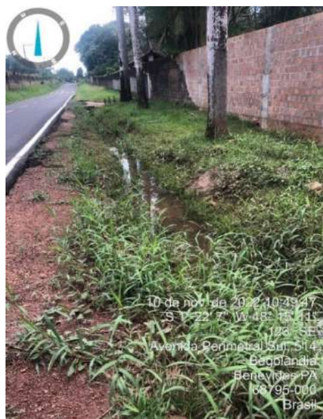
Figura 107: Canaleta em solo presente na Avenida Perimetral Sul, Bairro Begolândia
