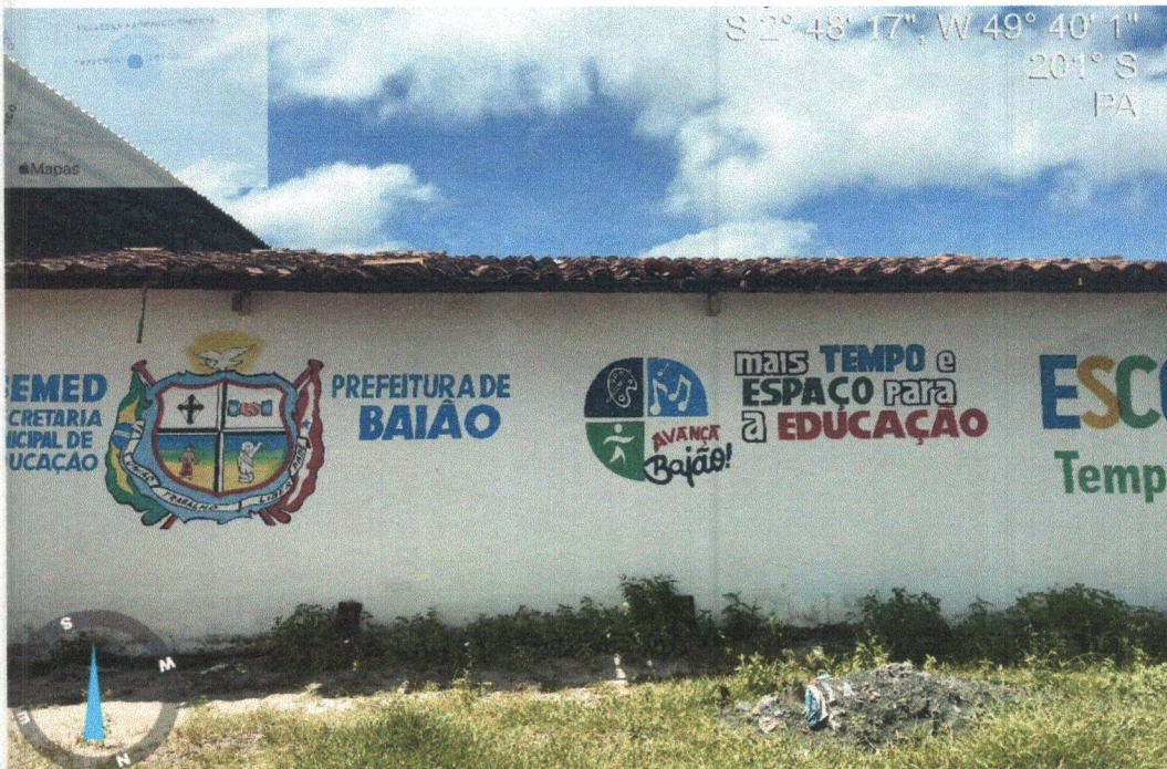
Imagem 04- fachada do prédio, com pintura antiga
