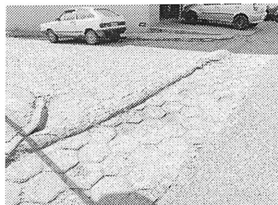
Quebra mola sem sinalização, feita de maneira irregular.
