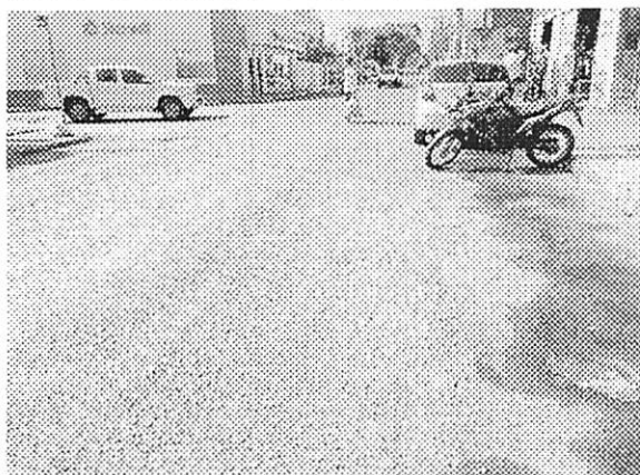
Pontos alagados na avenida pela ausência de galerias de águas pluviais.
